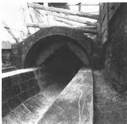
Abb. 6. Sohle einlagen aus Steinzeug schützen die Betonröhren vor der Zerstörung durch aggressive Flüssigkeiten (Bauaufnahme)
