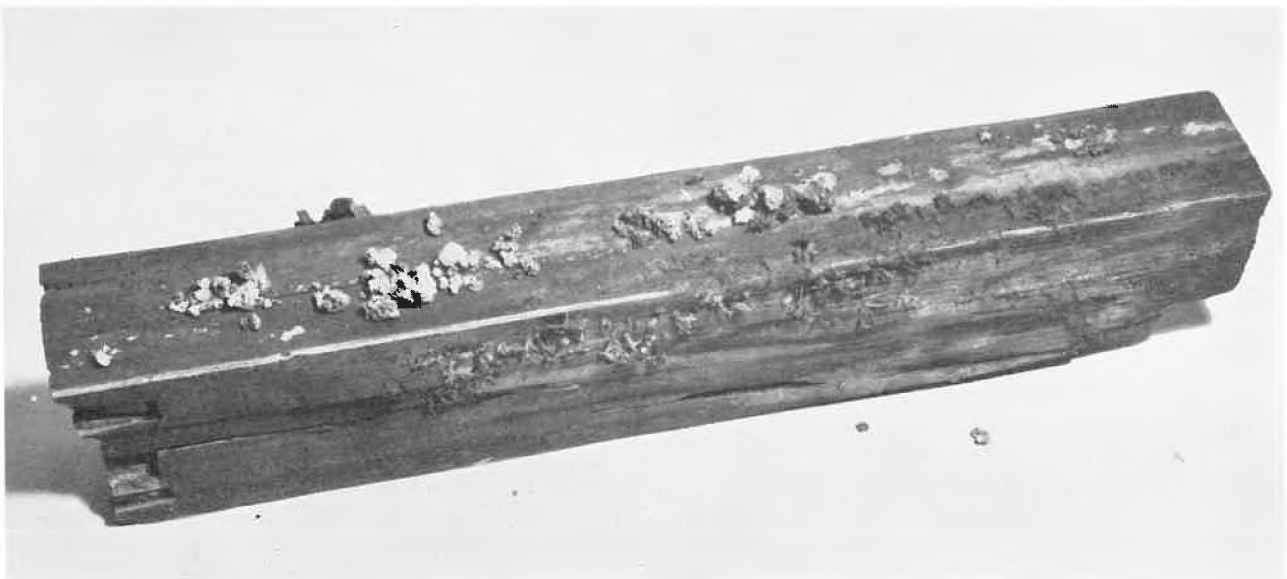
Abb. 3. Zerstörter Riegelbalken mit korallenartigen Oberflächenwucherungen von Lenzites abietina und weißen, knolligen Fruchtkörpern von Trametes serialis (Aufnahme: EMPA-C, St. Gallen)
