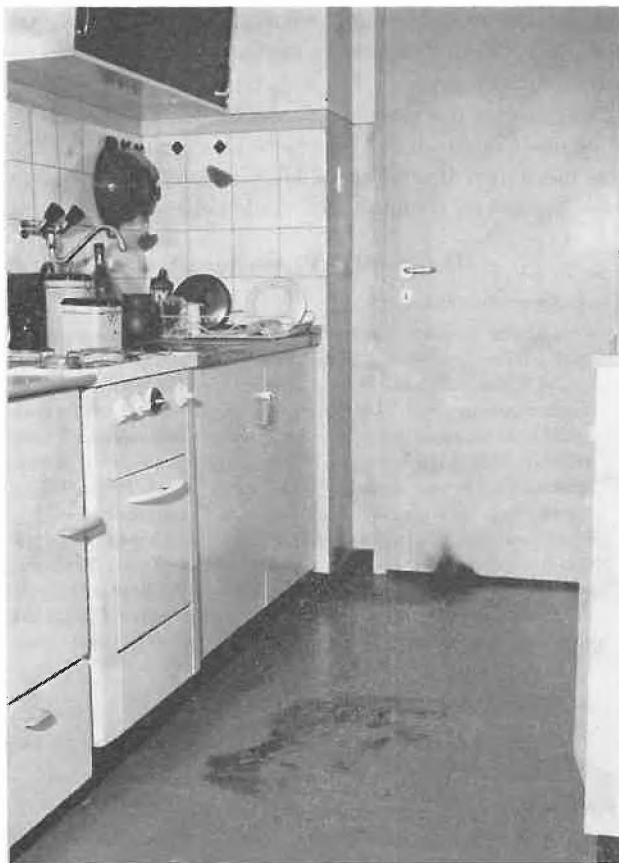
Abb. 1. Teilansicht der Küche mit angekohltem Fußboden
