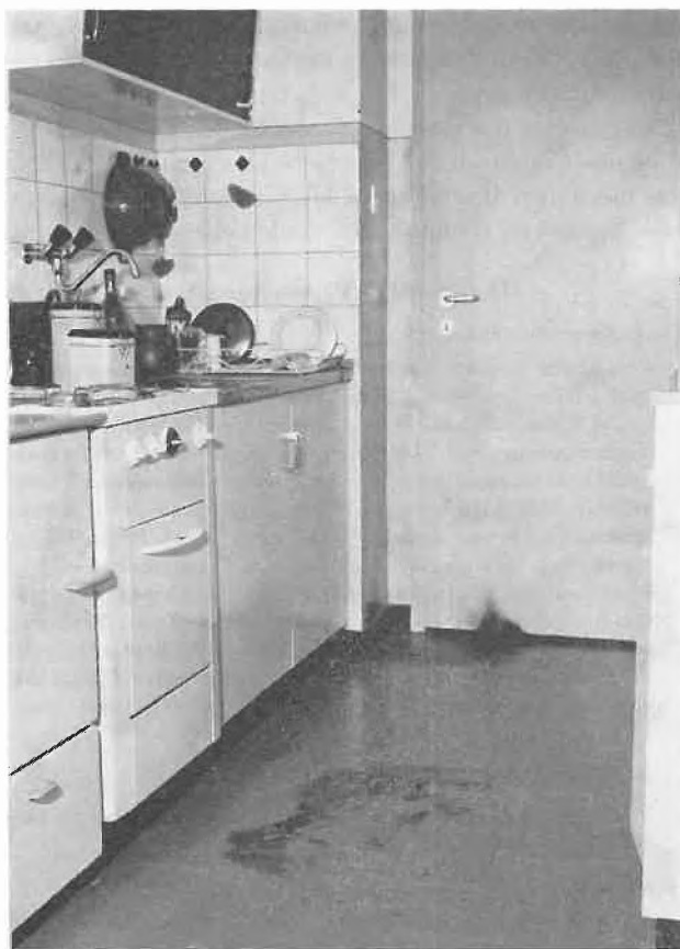
Abb. 1. Teilansicht der Küche mit angekohltem Fußboden
