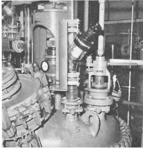
Abb. 8. Starke Metallschutzwand vor einer Glasleitung eines Betriebskessels. Beim Öffnen des Mannlochdeckels kann das Glas nicht zertrümmert werden. Beachte den Metallschutz für das Thermometer! An der Stopfbüchse ist ein Anlegethermometer befestigt zur Kontrolle der Erwärmung durch die Rührerdichtung und eventuell durch Wärmeleitung aus dem Kesselinhalt entlang der Rührwelle
