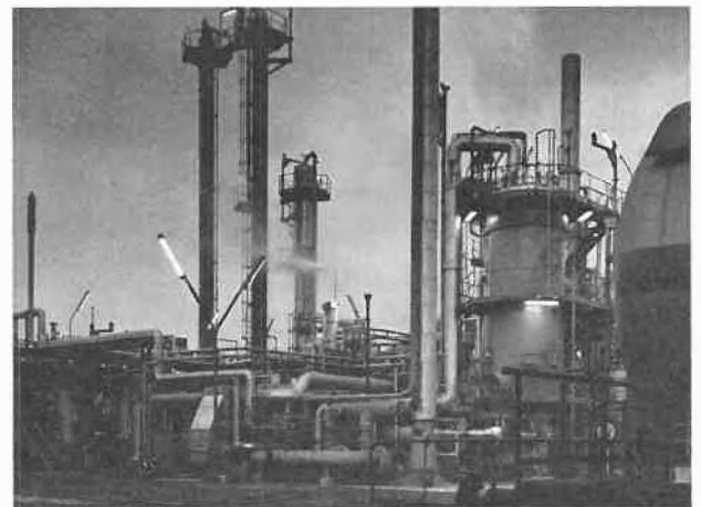
Abb. 34-7. Spaltanlage zur Erzeugung von Reinwasserstoff aus Benzin. Rechte Bildseite: Spaltofen; linke Bildseite: zweistufige CO 2 -Wäsche mit Stripper
