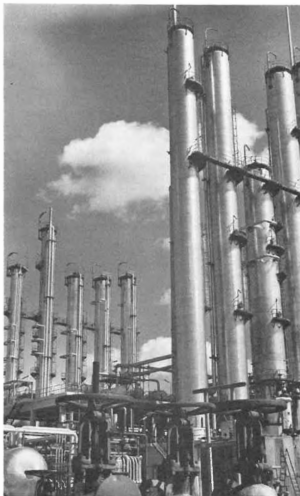
Abb. 2. Shell-Raffinerie Pernis, Rotterdam. Anlage zur Erzeugung von synthetischem Gummi (Butadien-Styrol-Kautschuk). Kolonnen im Vordergrund gehören zur Butadien-Anlage, diejenigen im Hintergrund zur Styrol-Anlage
