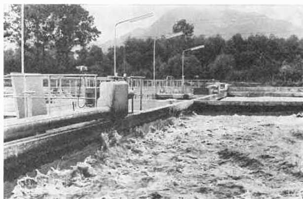
Abb. 5. Teil des Belüftungsbeckens
