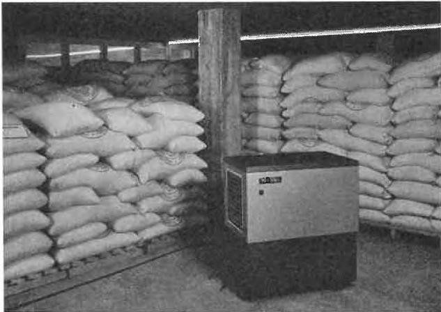
PRETEMA-Raumluft-Entfeuchter PR 200-HG in einem Zuckerlager
