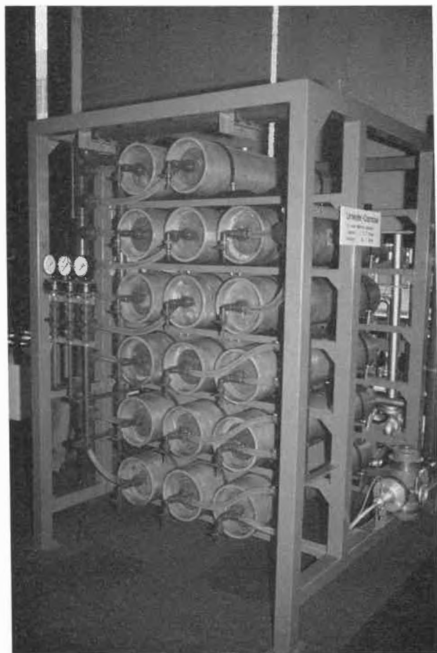
Abb. 16: Teil einer Umkehrosmose-Anlage für eine Leistung von 75 m 3 /h, Firma Hager und Elsässer, Stuttgart.
