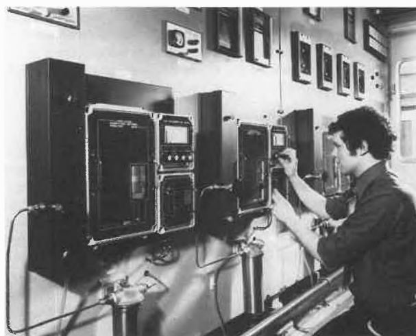
Fig. 1: Un contrôle final de routine est effectué sur l'un des analyseurs équipant un laboratoire préfabriqué destiné à l'analyse de l'eau dans une centrale thermique, ou à l'analyse des effluents industriels.
