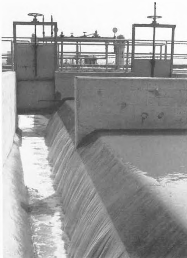
Abb. 3: ARA-Rhein: Kommunalabwasser-Zulauf zum Sandfang.
