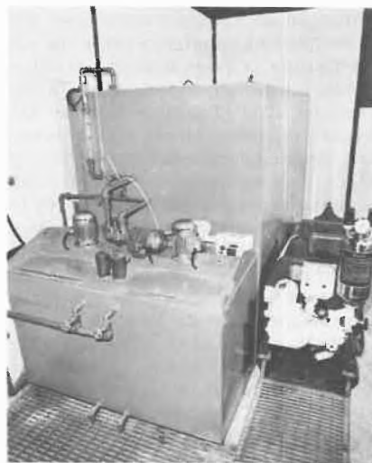
J&L Gaswaschanlage mit Aufbereitungsbehälter für Chemikalien, Reaktor und Filterpresse
