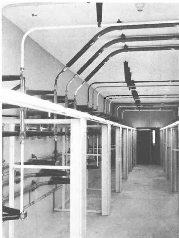
Abb. 17: Hochspannungsschaltanlage mit abgebo- genen, kapazitiv gesteuerten Enden an der Decke (Moser-Glaser & Co. AG., A. Imhof und H. Felix).
