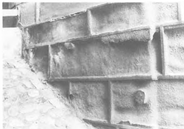
Fig. 5: Désagrégation sableuse de la molasse laissant des joints «durs» et des ragréages en relief. Escaliers du Marché, Lausanne.
