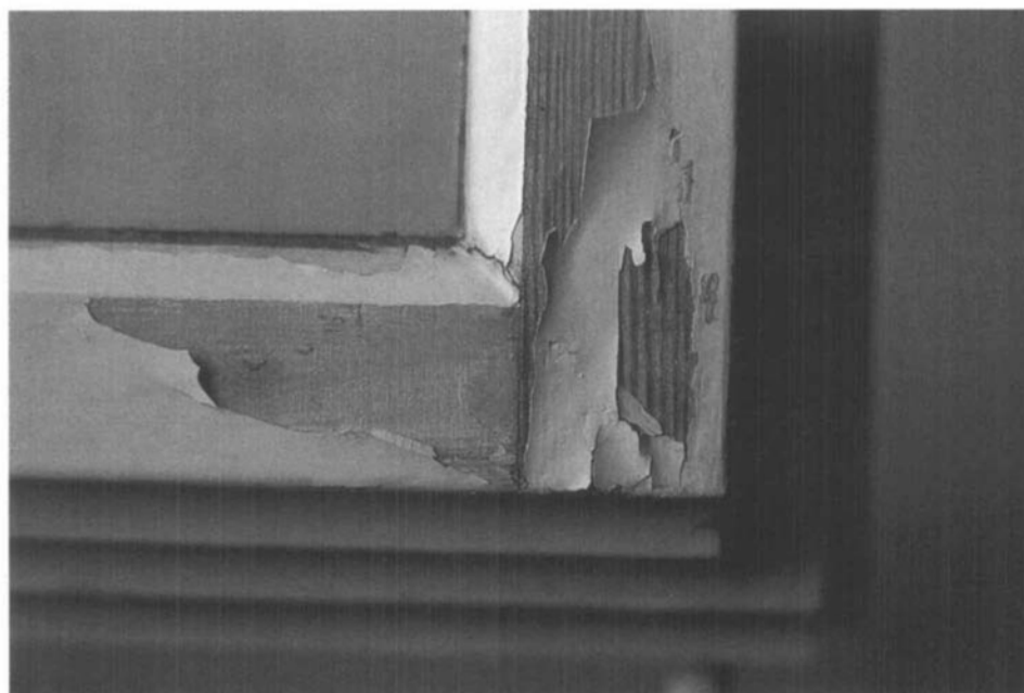
Fig. 1. Abblättern des Farbfilms und Vergrauung des Holzes bedingt durch einen Bewuchs durch Bläuepilze
